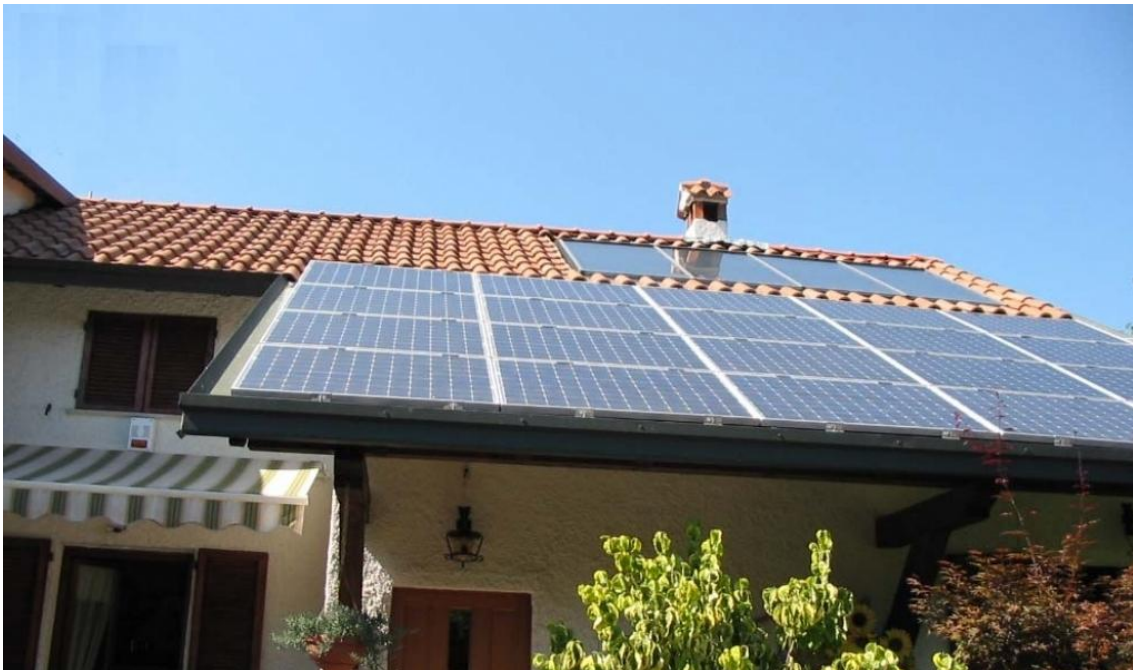
Figura 2.7: Dos tipos de células solares y su aspecto. Arriba insolación y mono cristalino, abajo cielo cubierto y multicristalino. Potencia máxima de 1kWp. Foto: Realizada por el autor.
